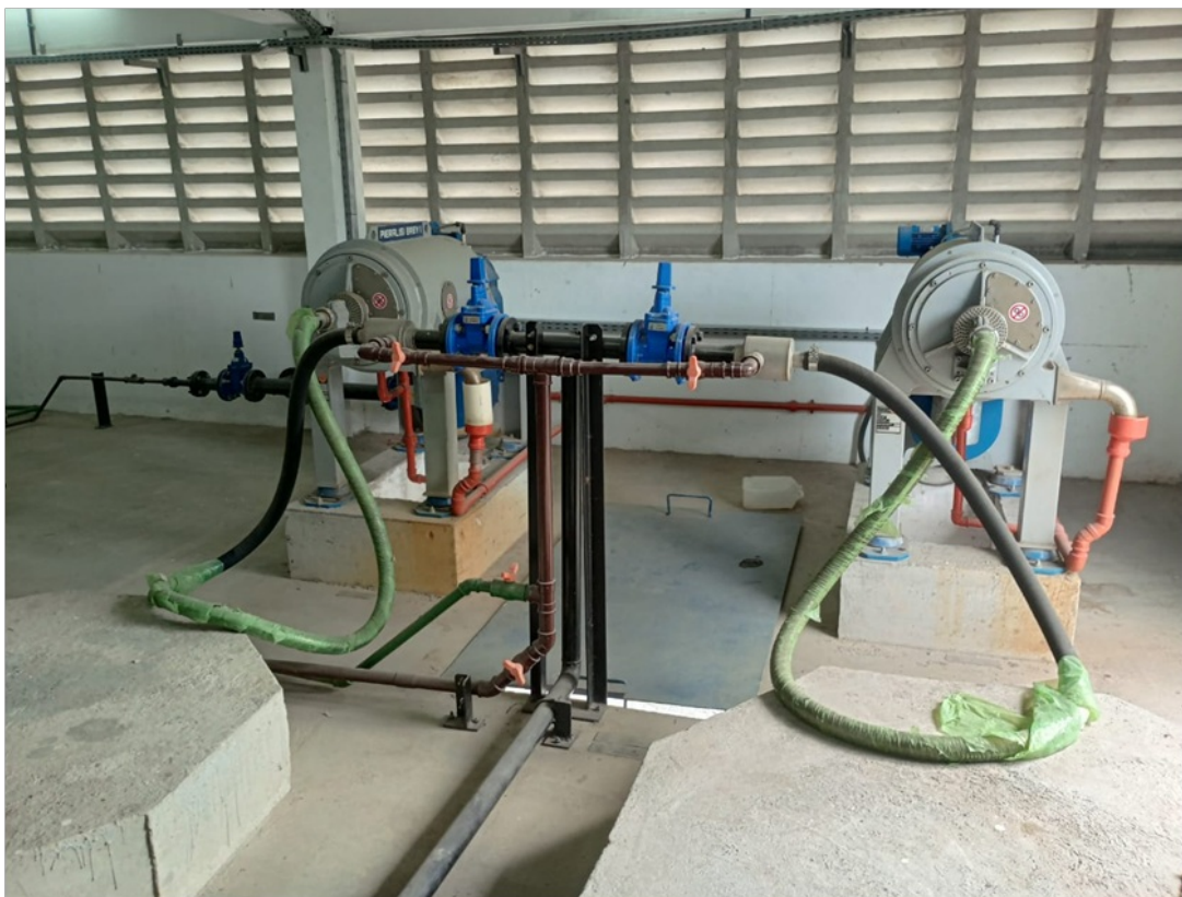
Foto 16 – Centrifugas que estão inoperantes desde a Concessão.
