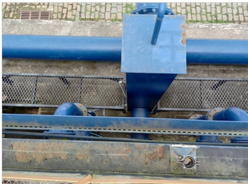
Foto 15 – Filtros ( quatro por módulo de tratamento) de areia e antracito que recebem a água decantada e a filtram por gravidade. Os filtros duas vezes por dia são limpos por retrolavagem, também por ação da gravidade.,com acionamento de válvula.
